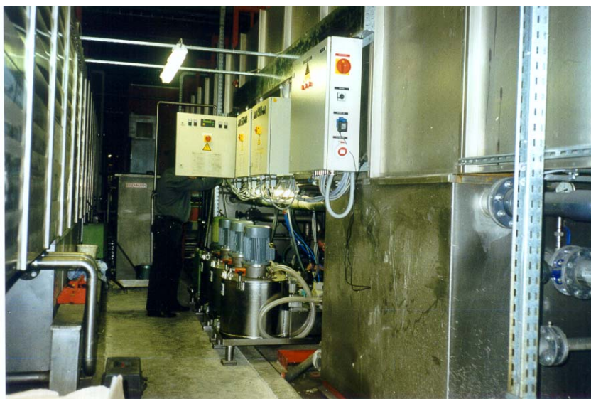
4 Zentrifugal-Separatoren installiert an Aktivzone 1 und 2
