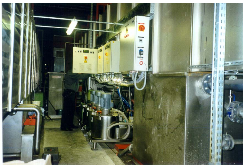
4 séparateurs centrifuges installés sur les zones actives 1 et 2
